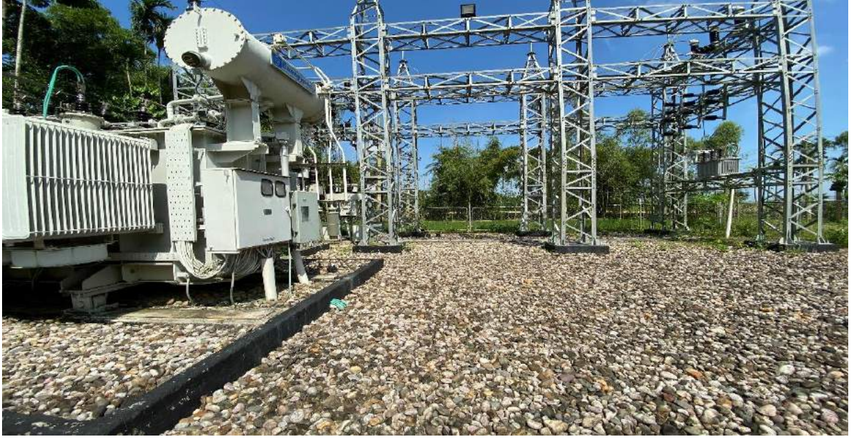
প্রকল্পের আওতায় নির্মিত ৩৩/১১ কেভি সাবস্টেশন এর স্থিরচিত্র
