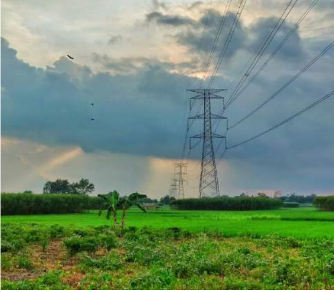
চিত্রঃ ভেড়ামারা-বহরমপুর ৪০০ কেভি সঞ্চালন লাইন।
